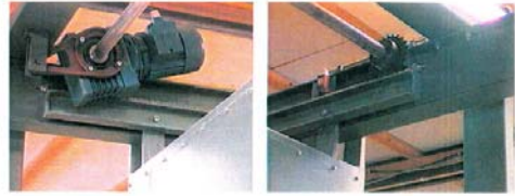
Elektromechanische aandrijving waarmee cabine geopend en gesloten kan worden.
